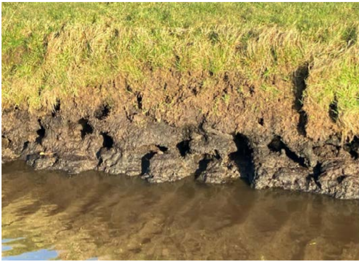
Figuur 7.1.3.: Graverij schade door (woel-) ratten. Deze schade treedt vooral op onder het slootpeil wat in de zomer wordt gevoerd.
