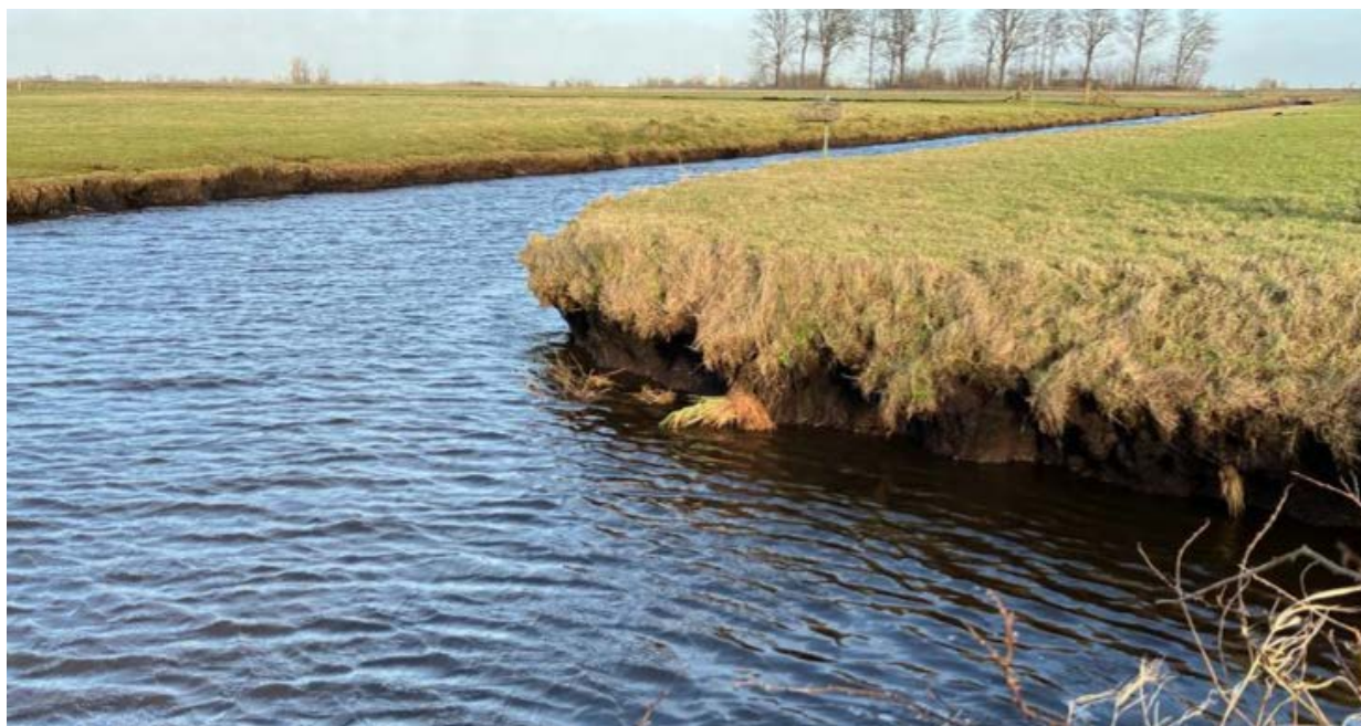
Foto 7.6.1: Locatie waar HAKLAM peilen in de zomer 40 cm hoger staan dan in de winter. Hierdoor ontstaat een stuk oever van 40 cm met minder begroeiing. Dit vergroot het risico op oeverinstabiliteit. Overwogen kan worden in droge perioden in het winterseizoen het peil minder laag te zetten, zodat de kwetsbare zone geminimaliseerd wordt.
